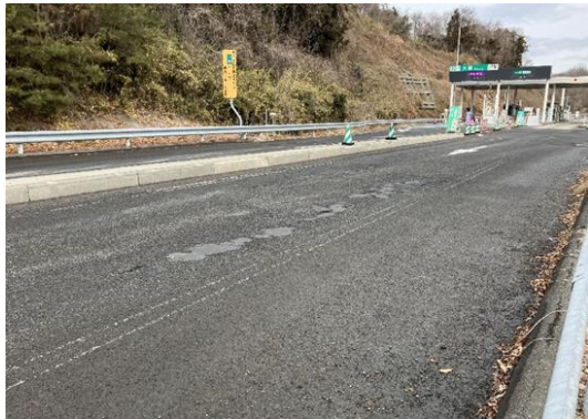
舗装損傷写真
