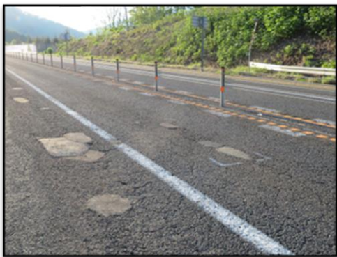
舗装損傷写真
