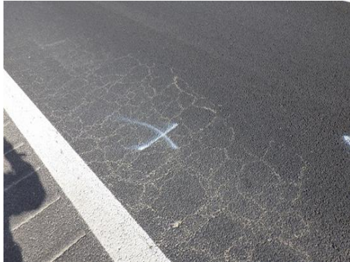
舗装損傷写真
