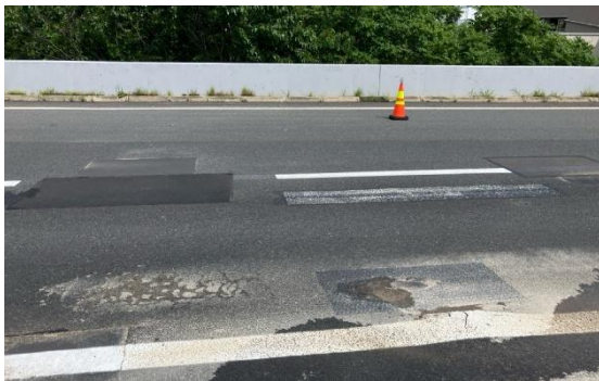
舗装損傷写真
