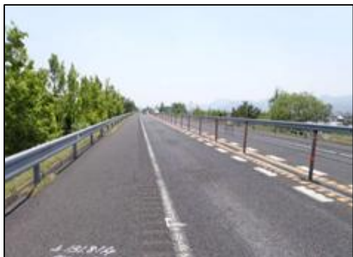
舗装損傷写真
