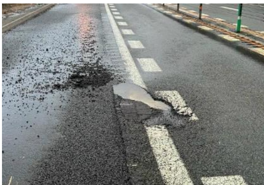
舗装損傷写真
