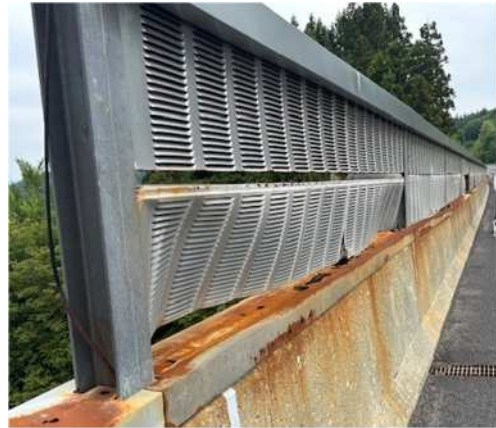
遮音壁損傷写真(拡大)
