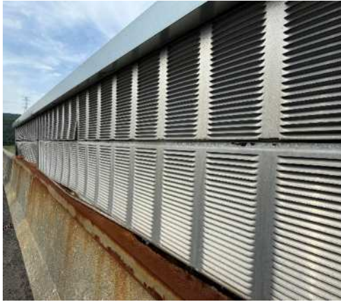
遮音壁損傷写真
