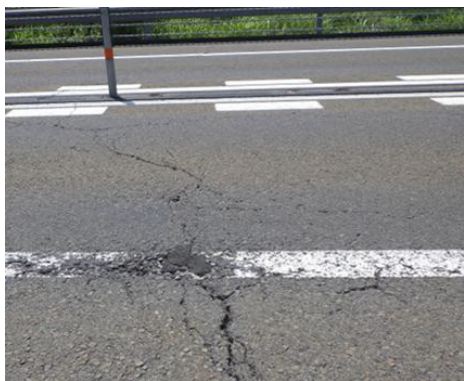
舗装損傷写真
