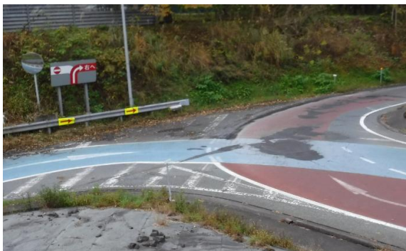
舗装損傷写真
