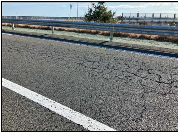
舗装損傷写真
