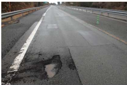
舗装損傷写真
