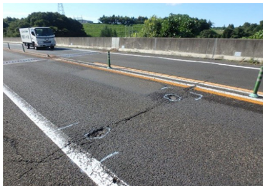
舗装損傷写真
