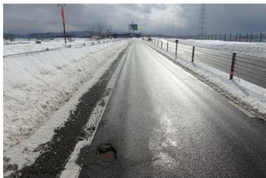
舗装損傷写真
