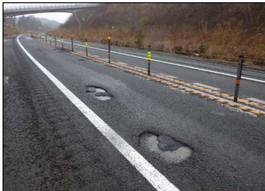
舗装損傷写真
