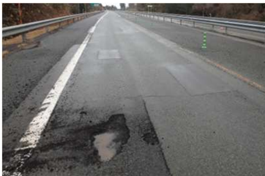
舗装損傷写真
