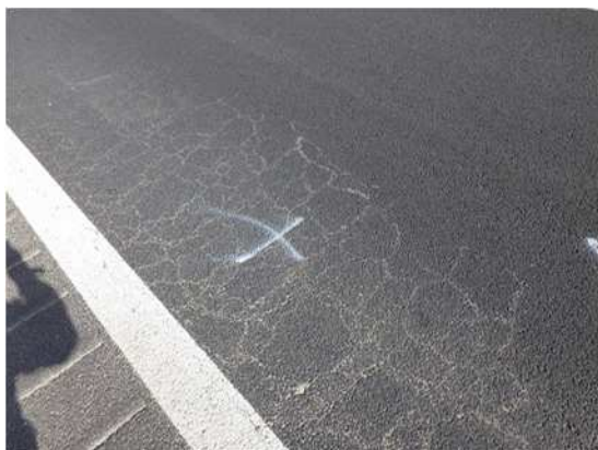
舗装損傷写真
